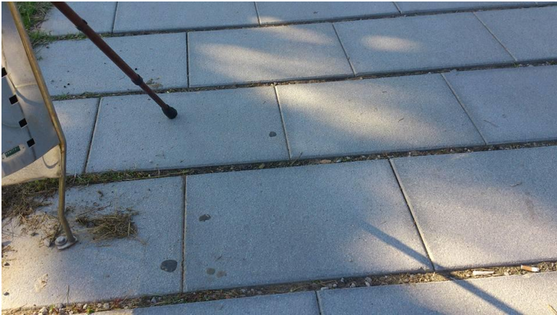
PAVIMENT FORA DE NORMATIVA
